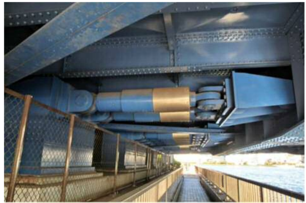
◆清洲橋に設置された制震ダンパー
