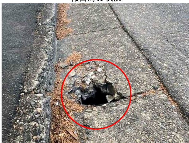
(3) L型側溝の損傷（青梅市大柳町） 報告時の状況
