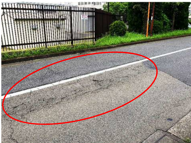
(1) 車道舗装の損傷（府中市東芝町） 報告時の状況
