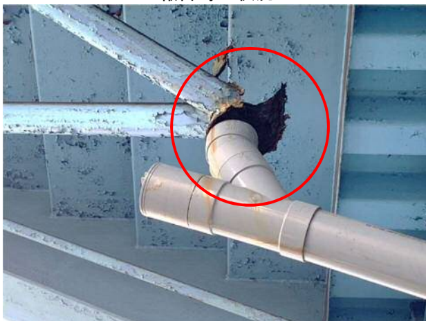
(2) 横断歩道橋排水管の損傷（新宿区下落合） 報告時の状況
