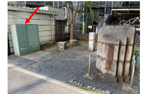
橋詰に設置した地上機器
