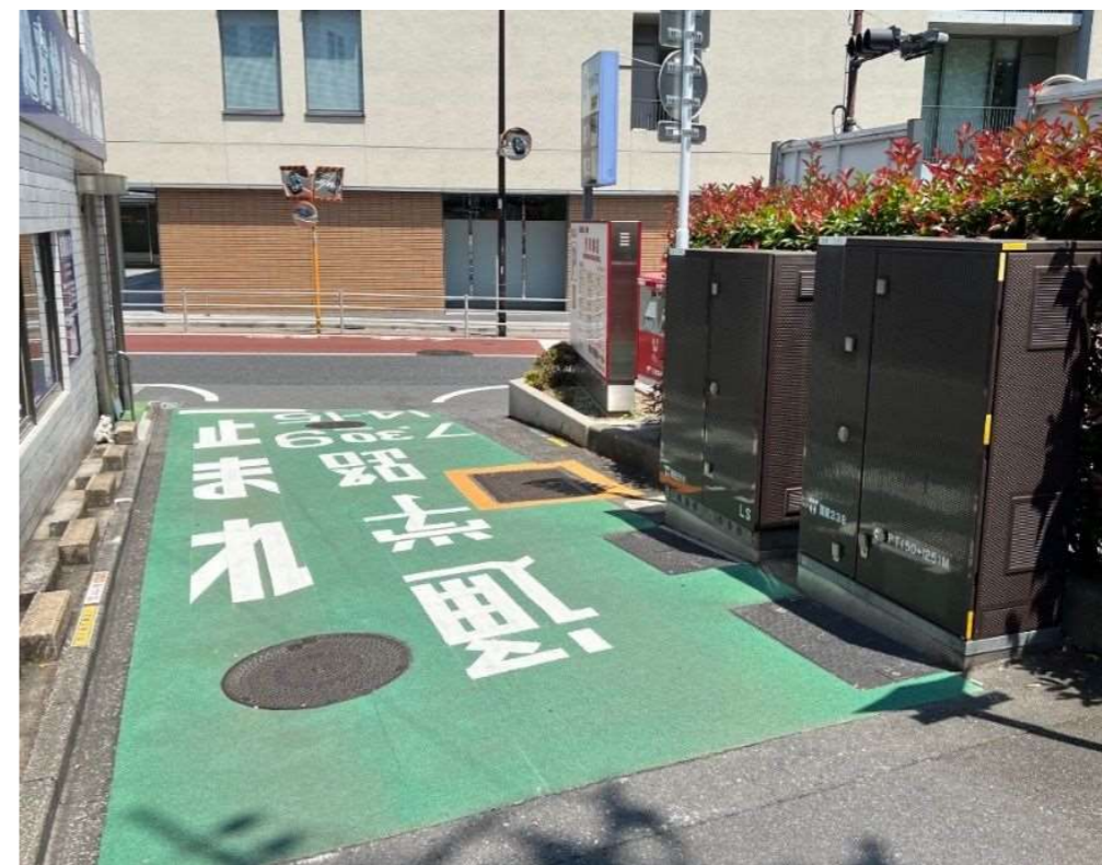
脇道に設置した地上機器
