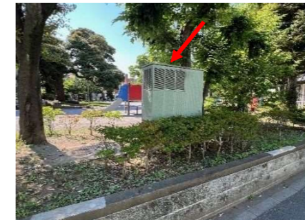
公園内に設置した地上機器
