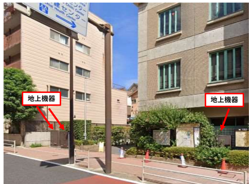
区有地内に設置した地上機器
