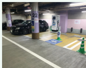
急速充電器 ▲ (東京都宝町駐車場)
